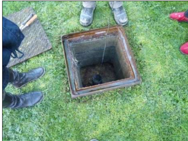
Photo 1: Diagnostic de bon fonctionnement réalisé par la CCS
